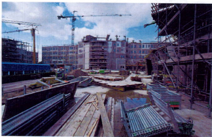
Een van de vier zogeheten vinders in aanbouw. Het nieuwe Isala-ziekenhuis moet in 2013 gereed zijn.
