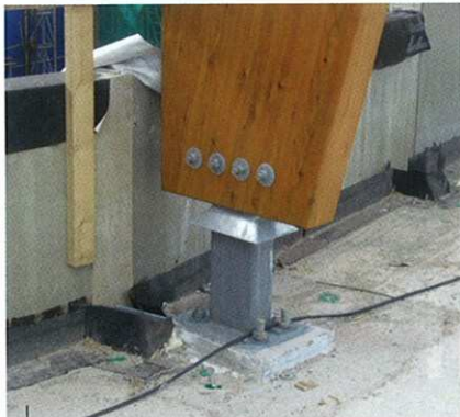
De spantbenen staan op stalen voetschoenen die zijn verankerd in de betonvloer.
